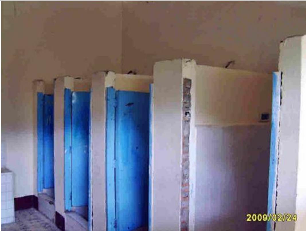
Unidad sanitaria del área de biblioteca y aula de bilingüismo
