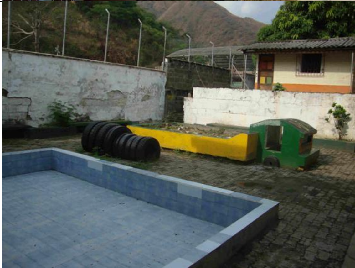
Detalle del área de desarrollo psicomotriz de preescolar, requiere adecuación de este espacio que representa peligro para los niños en especial el balcón sin terminar y el muro de separación de las dos áreas
