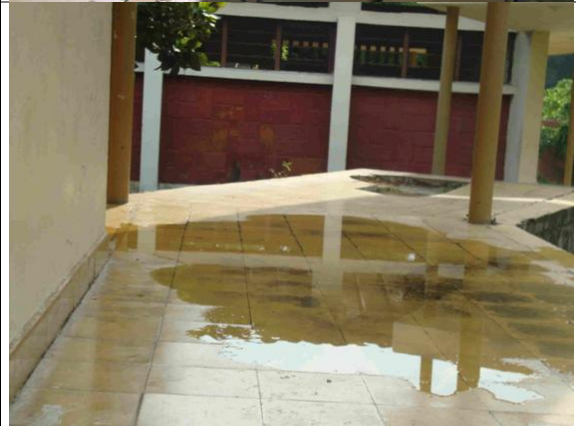
Detalles de corredores que se encuentran en inadecuadas condiciones y representan peligro para la comunidad educativa
