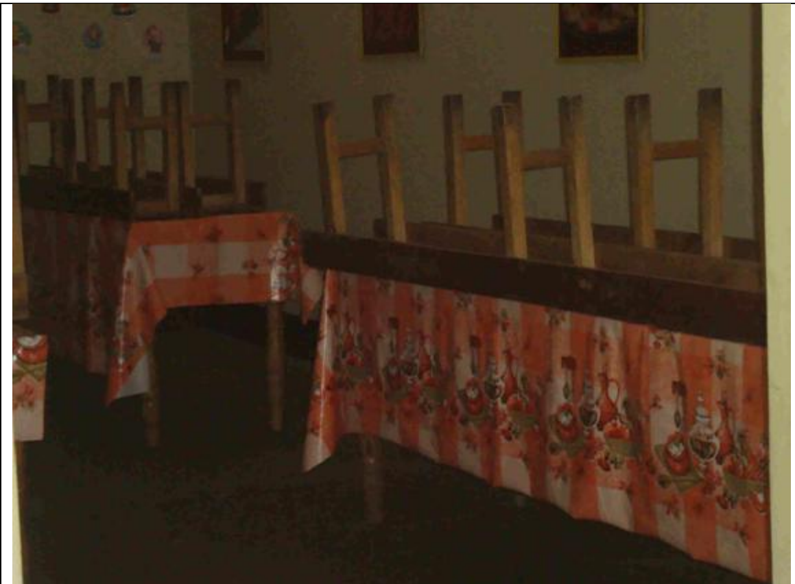
Detalle de dos áreas del restaurante escolar, requieren adecuación del piso, unificación de los salones para crear un espacio único
