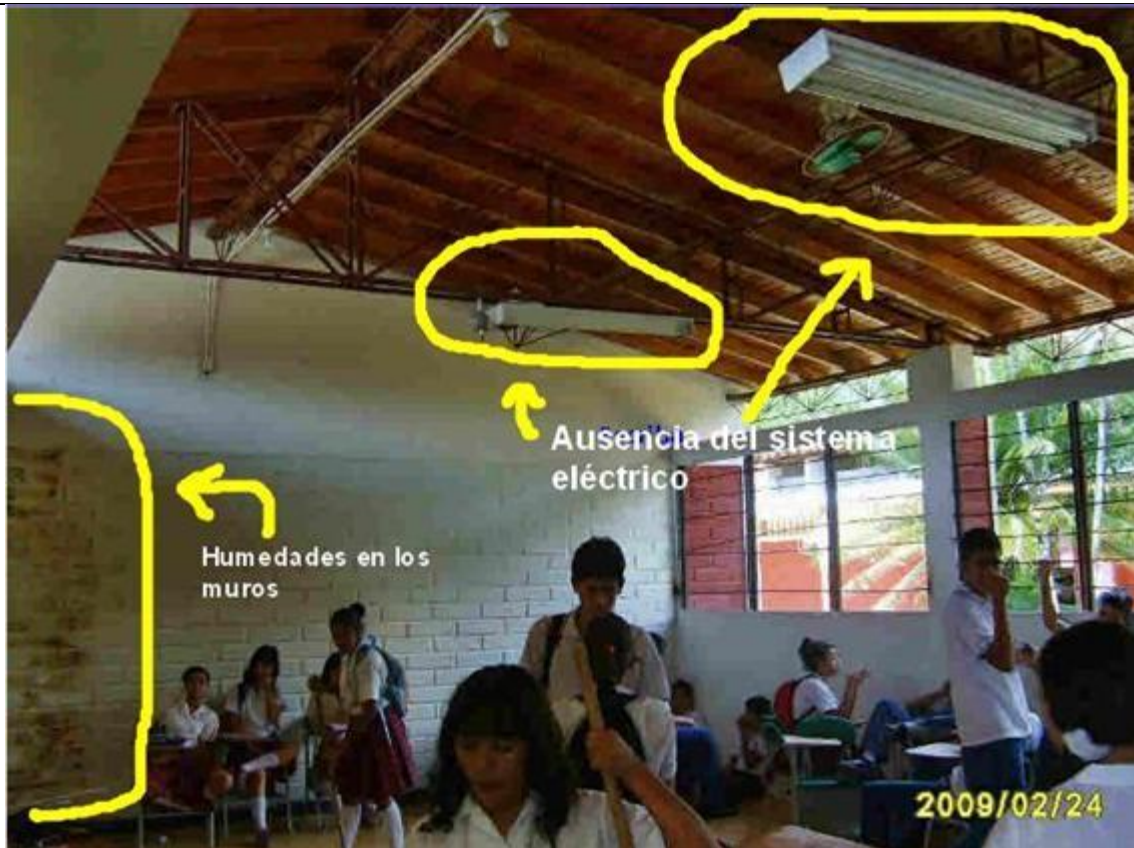
Las aulas de clase no cuentan con el servicio eléctrico requerido para la iluminación y la ventilación
