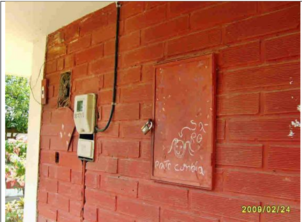
La Institución no cuenta con una adecuada instalación eléctrica
