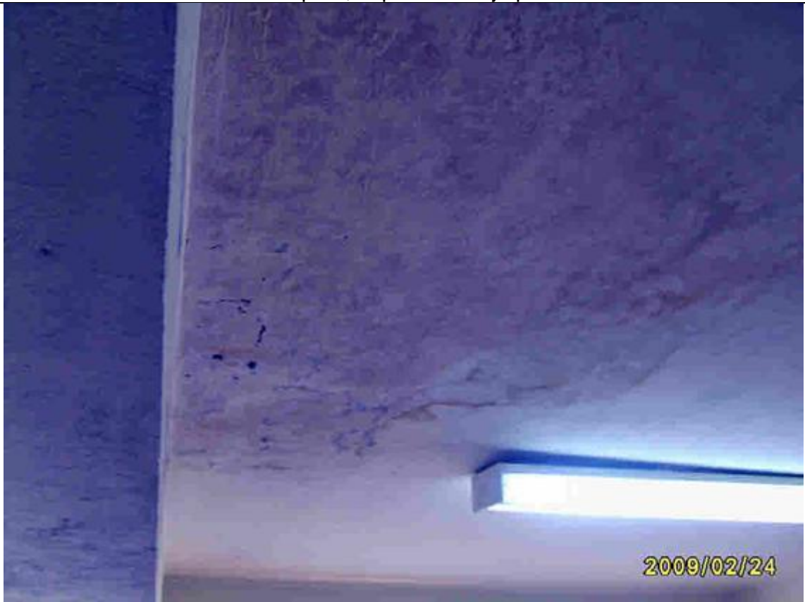
Humedades en la plancha
