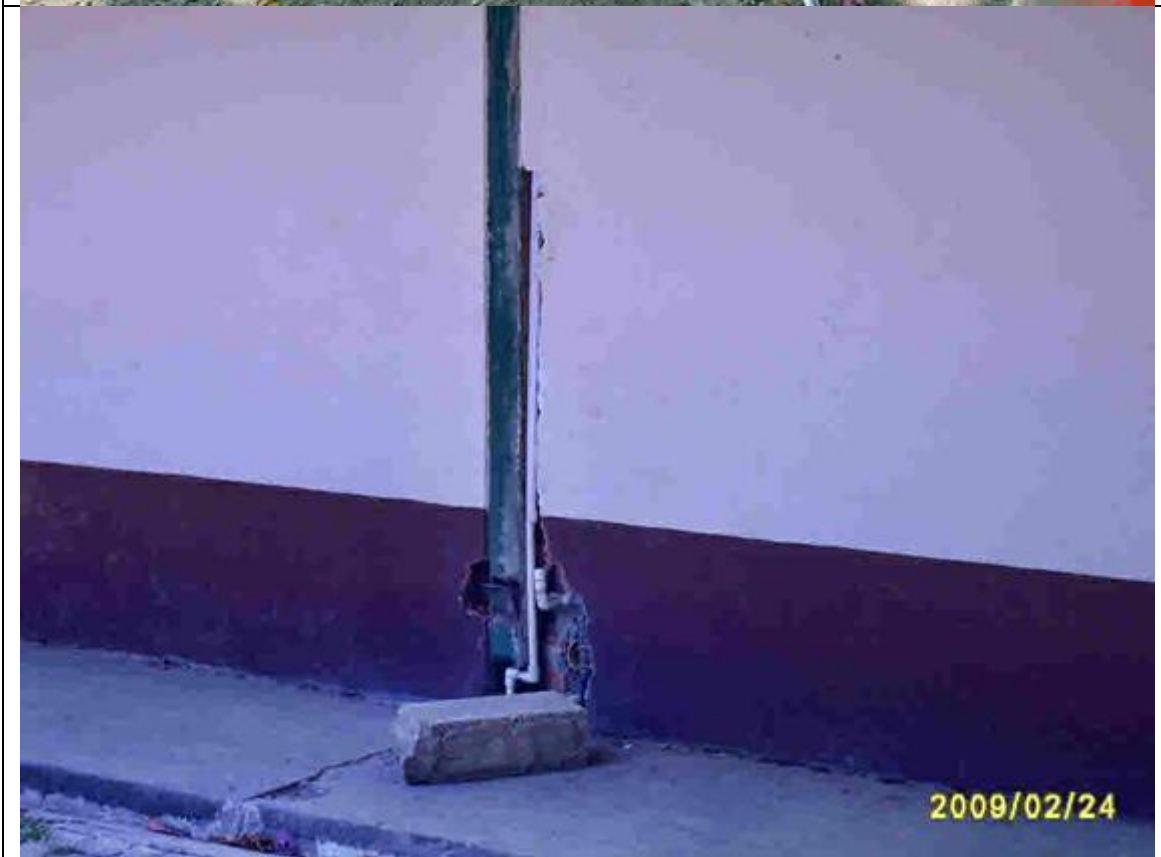
Detalle de la tubería que alimenta el agua en la unidad sanitaria de primaria
