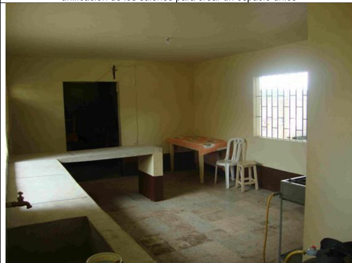
Detalle de la cocina del restaurante escolar, requiere adecuación en cuanto al piso, lavaplatos, hornilla y fogón.
