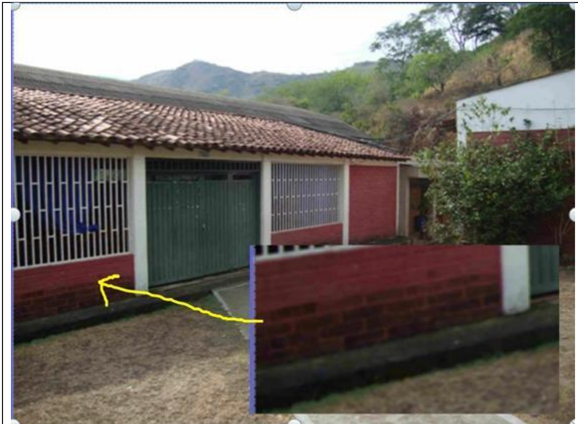
Detalle de los muros del aula múltiple, requiere urgentemente revoque
